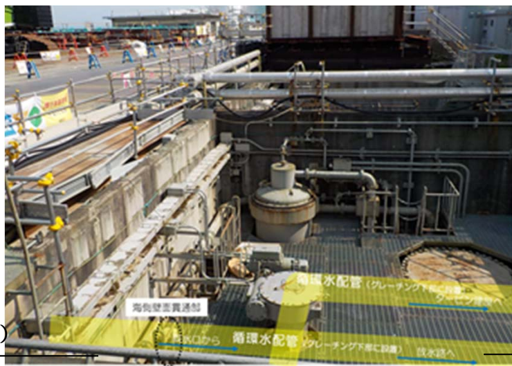
逆洗弁ピット(2号機)
