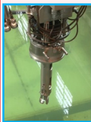
燃料取扱機(マスト)
