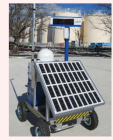
線量率モニタの設置状況
