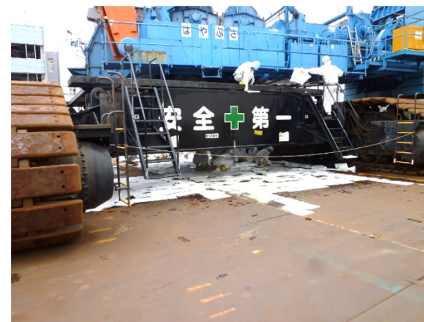
作動油漏えい状況
