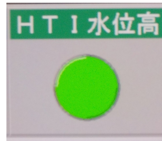
高温焼却炉建屋（HTI）水位高警報窓
