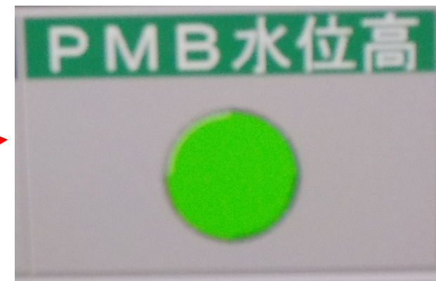
プロセス主建屋（PMB）水位高警報窓
