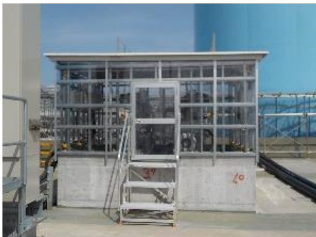
【移送ポンプハウス】
