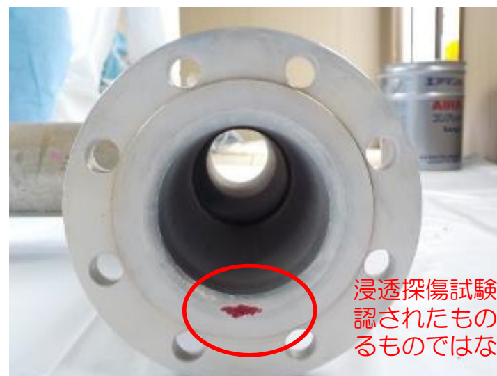
フランジ部（鋼管側）浸透探傷試験結果
