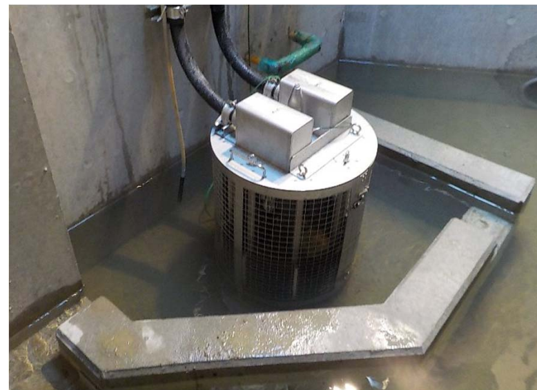
モニタ設置状況
