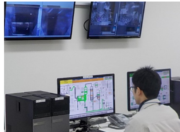
制御室 試験作業状況
