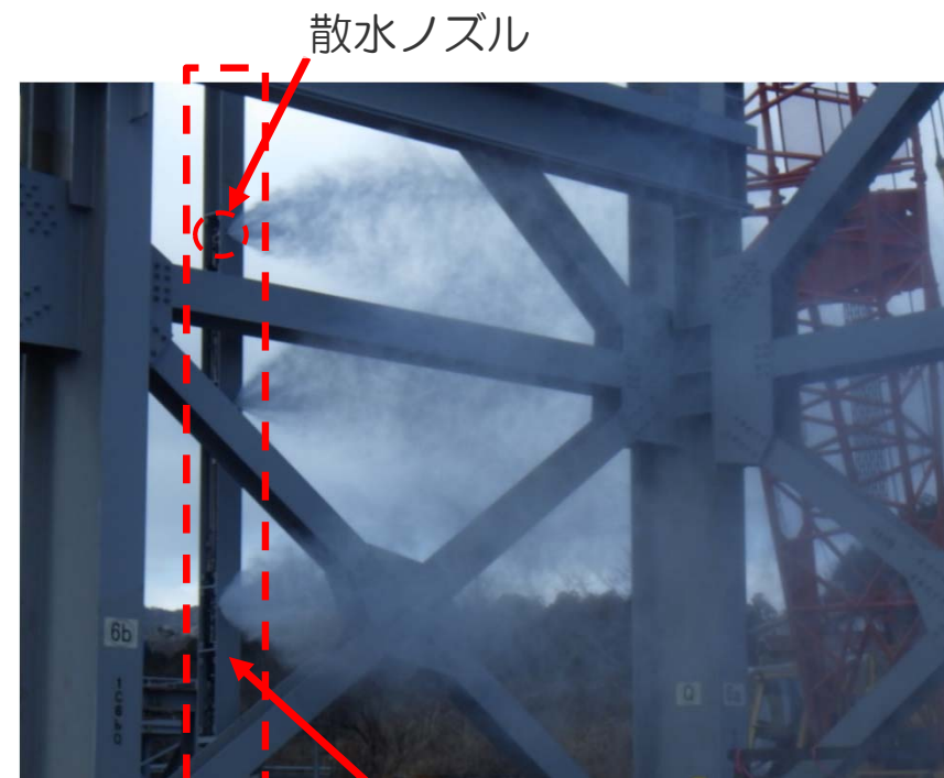
ノズルユニット 散水設備モックアップ状況写真 （構外ヤード）
