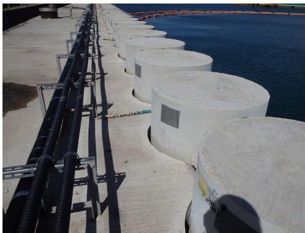
鋼管矢板際の状況（補修実施前） （右写真の補修実施後の場所とは異なる）
