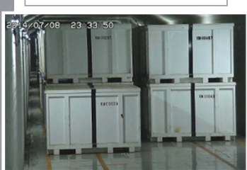
固体廃棄物貯蔵庫
