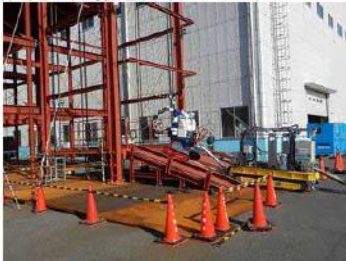
■ 作業台車・搬送台車 リフト乗入
