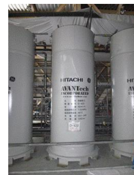
サブドレン等浄化 (吸着塔)
