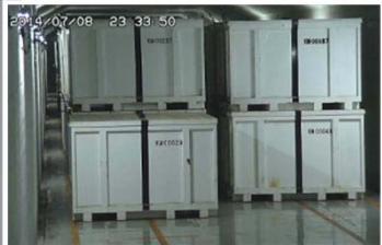
固体廃棄物貯蔵庫
