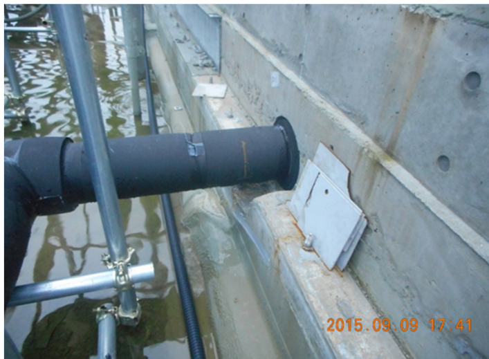
配管貫通部下部より漏洩 (鉛筆1本程度の太さ)
