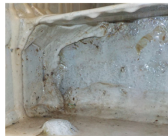
漏洩箇所内側の状況
