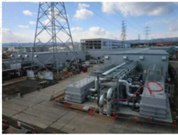
冷凍機が設置されている冷凍プラント建屋
