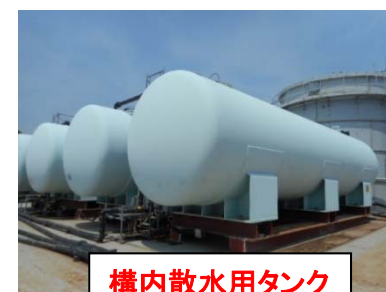
構内散水用タンク
