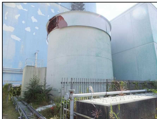
②廃液サージタンク
