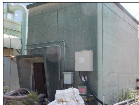
⑦セメントブローアー室
