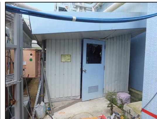
④HCU窒素ガスポンベ室
