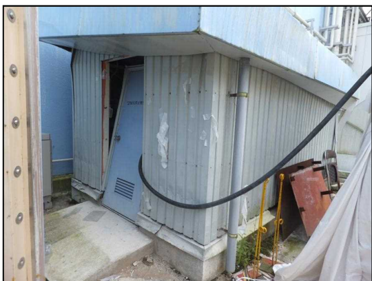
⑤MS/SRV窒素ガスポンベ室
