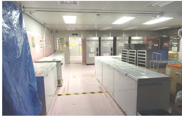
保冷剤冷凍庫の配備
