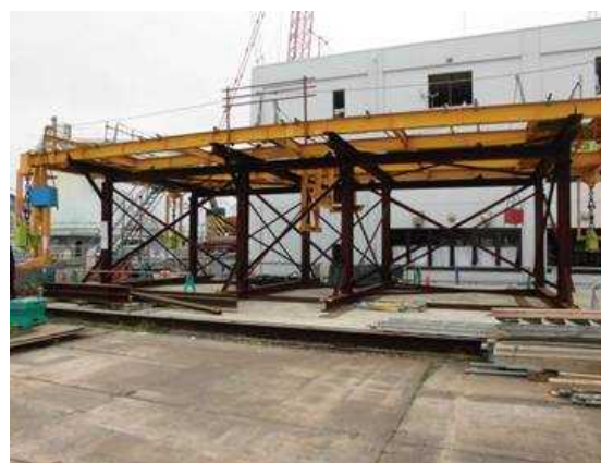
屋根パネル取り外し用装置・架台
