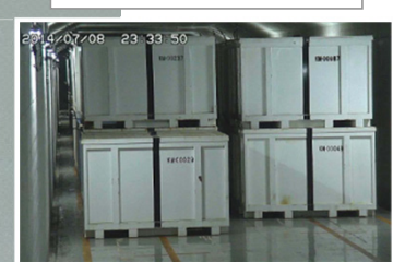
固体廃棄物貯蔵庫
