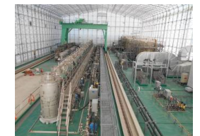
(高性能多核種除去設備の設置状況)
