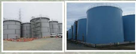
タンクの設置状況
