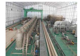
(高性能多核種除去設備の設置状況)
