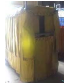
足場囲い型遮へい体
