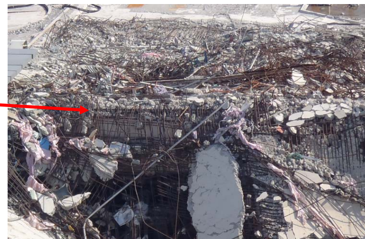
写真②北西崩落部拡大写真
