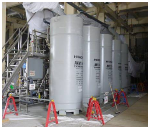
浄化設備（吸着塔）
