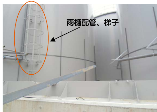
J1エリアタンク、雨樋配管、梯子について目視点検を行い異常なし。
