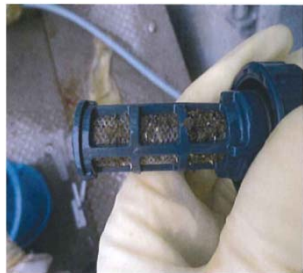
エアコンストレーナ詰まり状況
