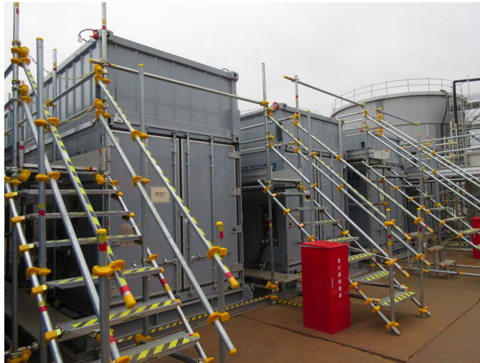
モバイル型ストロンチウム除去装置（A系統）の設置状況
