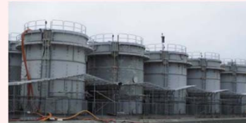
堰カバー設置後
