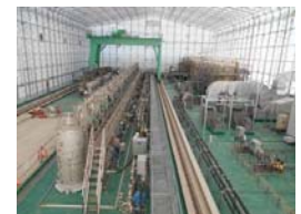
(高性能多核種除去設備の設置状況)
