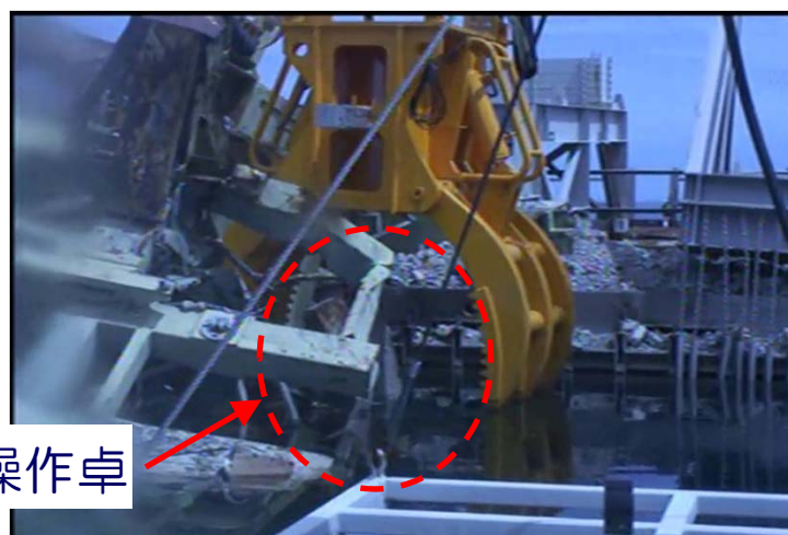
写真③ 爪5本で撤去しようとした状況 (西側 側方より撮影)
