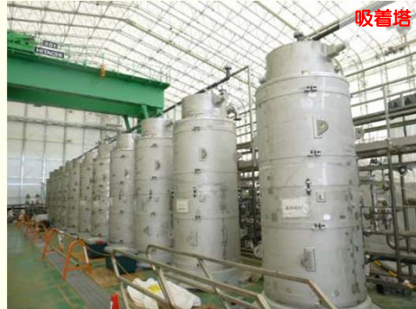
<高性能多核種除去設備 設置状況>
