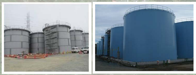
タンクの設置状況
