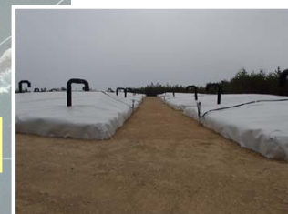
伐採木一時保管槽
