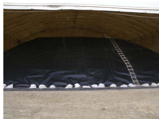
1 槽目内部の状態 (H24/12/13)
