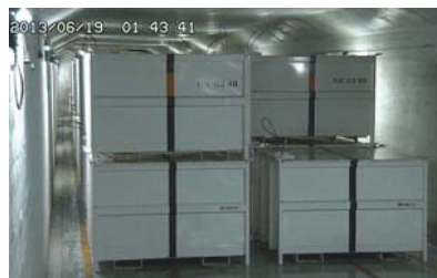
固体庫8棟地下
