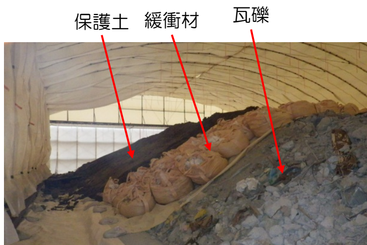
1 槽目内部の状態 (H24/11/1)
