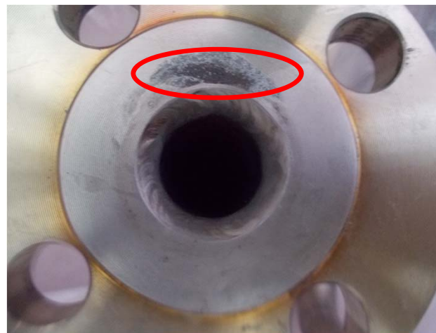
吸着塔 2 B ベントフランジ（下流側）の様子*
