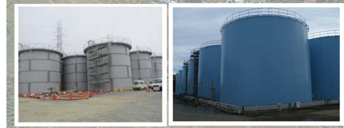
タンクの設置状況
