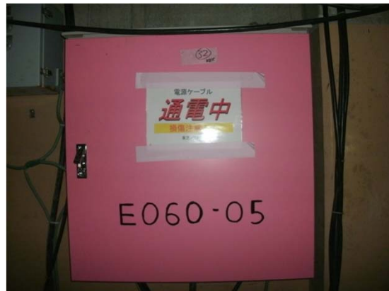
仮設分電盤 (焼却工作建屋1階)
