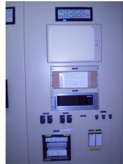
共用プールエリアモニタ盤
