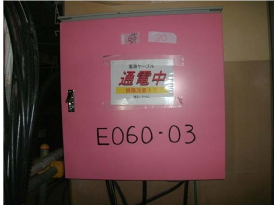
仮設分電盤 (プロセス主建屋2階)
