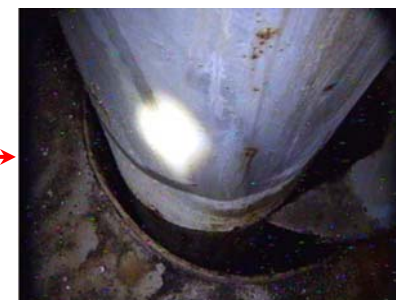
床貫通部 (事故当初、トラス室からの蒸気噴出が確認された箇所)
