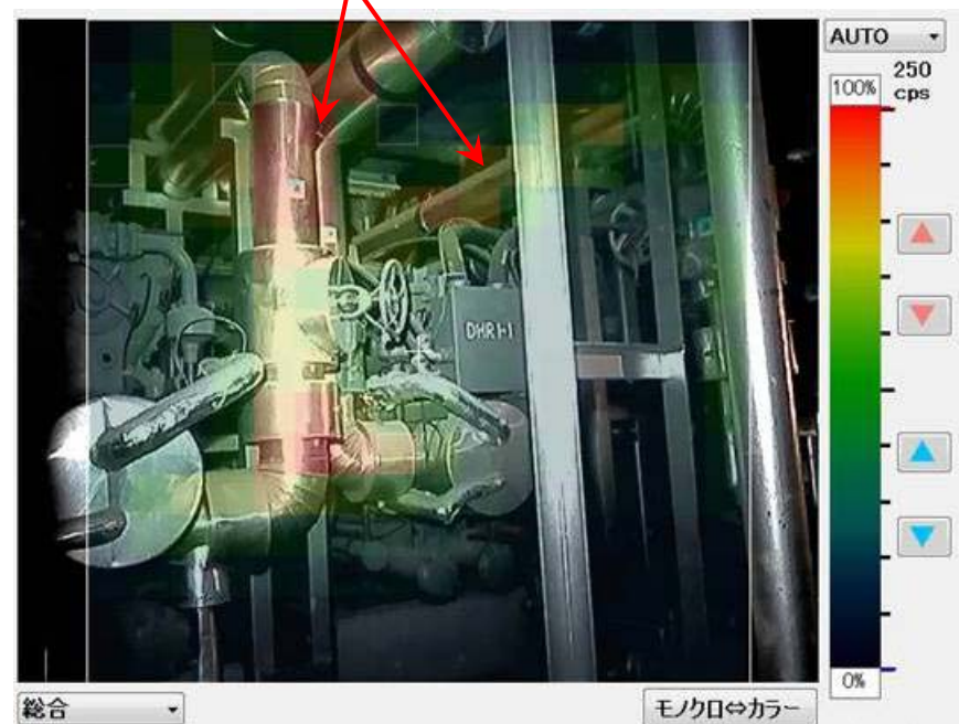
図10 ドライウェル除湿系冷凍機付近ガンマカメラ画像
