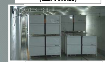
固体廃棄物貯蔵庫
