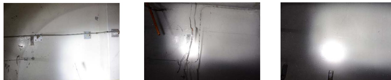
図3：1号機 機器ハッチに面する西側壁面(中央部)（左から順に4階、3階、2階）
