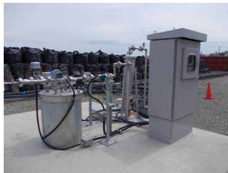
No. 12揚水井および揚水・移送設備
