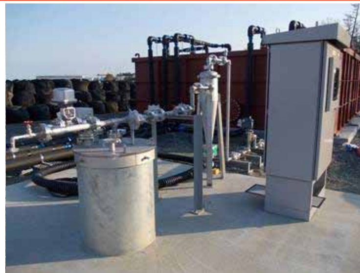
No. 9揚水井および揚水・移送設備
