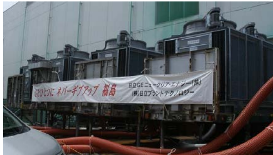
使用済燃料プール 循環冷却装置
