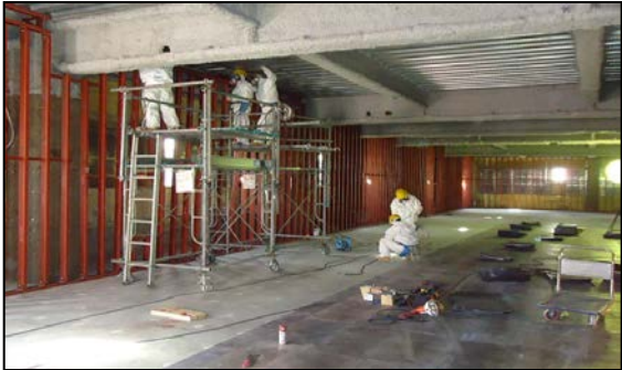
床・壁鉛遮へい
