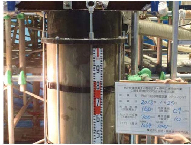
〔打設開始160 分後〕 止水せず(漏水流量11L/分)
