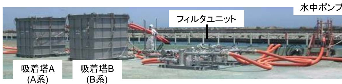
図 装置全体外観(上)と吸着塔(右)
