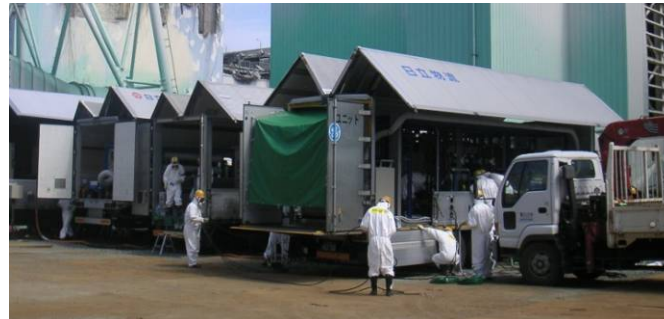
塩分除去 逆浸透膜(RO)装置
