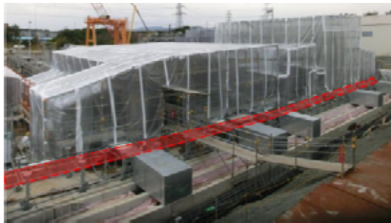
<多核種除去設備設置状況>
