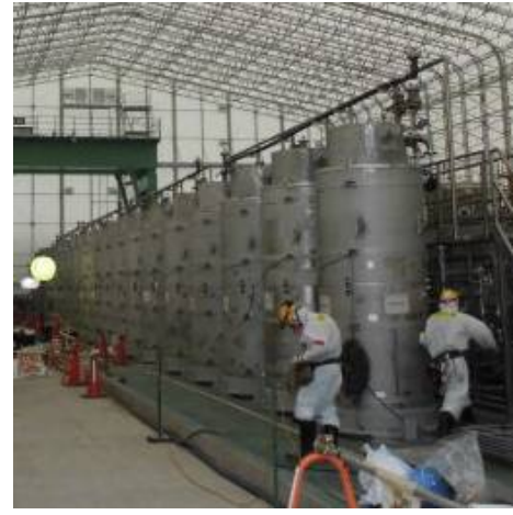
高性能多核種除去設備吸着塔
