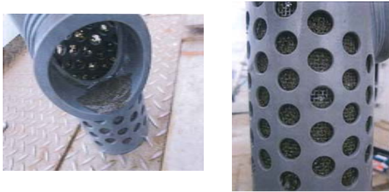
陸上ストレーナ詰まり状況
