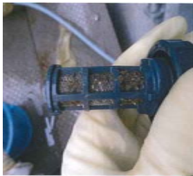
エアコンストレーナ詰まり状況
