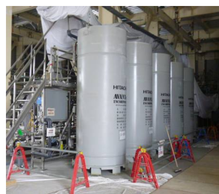
浄化設備 (吸着塔)
