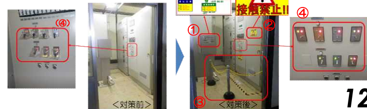
原子炉注水設備制御盤 B
