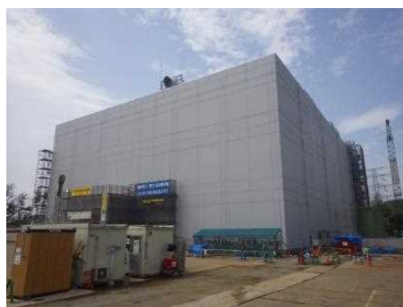
雑固体廃棄物焼却設備（建屋全景）
