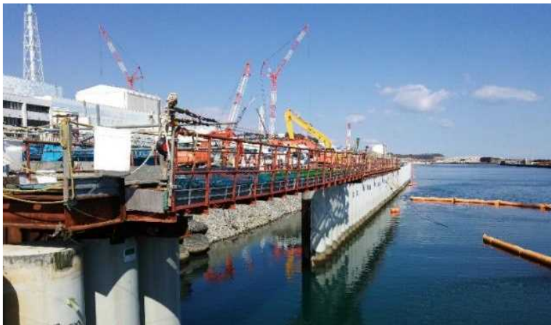
<写真①：海側遮水壁閉合箇所：鋼管矢板9本分（延長約10m）>
