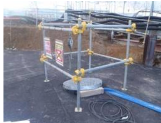
是正後（開口部にバリケードを設置）
