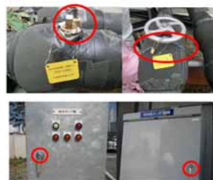
弁・電源盤の施錠管理
