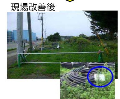
現場改善前 現場改善後 (例)エリアキーパーの活動により、資材が片付けられ、仮置の表示もなされた
