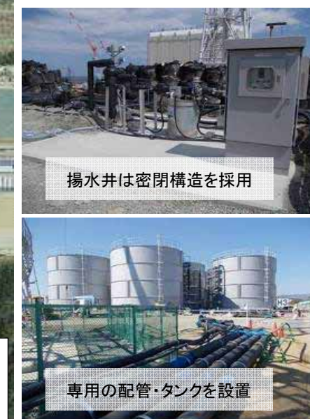
<揚水井等の設置状況>
