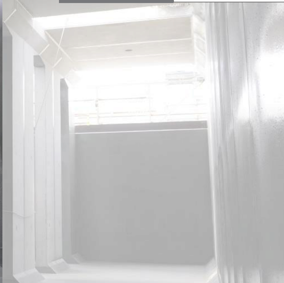
上流水槽 (ALPS処理水希釈放出設備)
