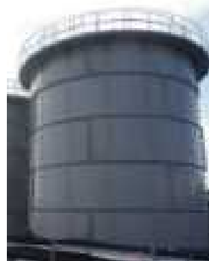
フランジ型タンク
