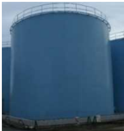
溶接型タンク
