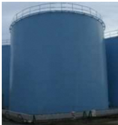
溶接型タンク
