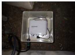
3号機に設置した地震計 (1階レベル)
