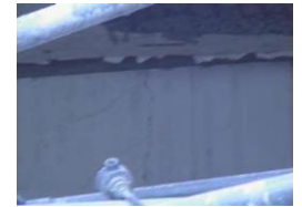
遠隔カメラ調査 (3号機4階 使用済燃料プール壁 2011年9月)
